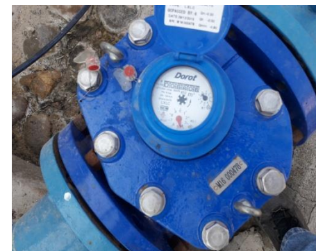
Pozo 24 Bucerías Oficina
