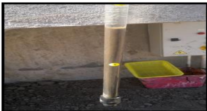
Pruebas y puesta en marcha: Revisión de la cama de lodos del clarificador secundario 1.
