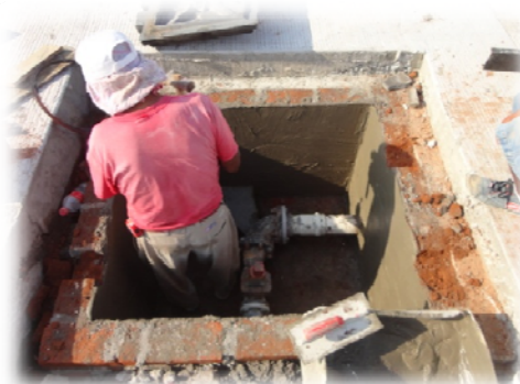
CAJA DE VALVULAS
