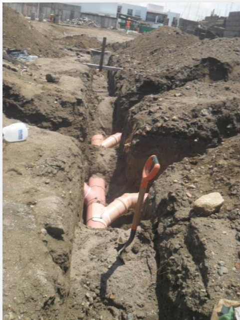
Instalación de Descarga domiciliaria
